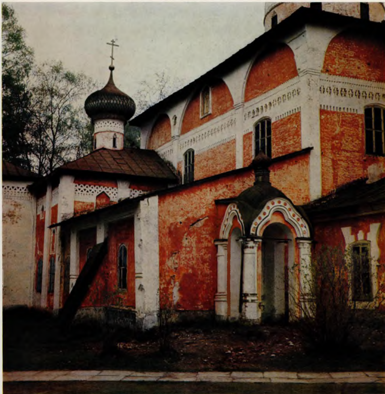
Cathedral of the Dormition. Part of the north façade with the Chapel of St Vladimir (1554) Успенский собор. Фрагмент северного фасада и церковь св. Владимира. 1554
